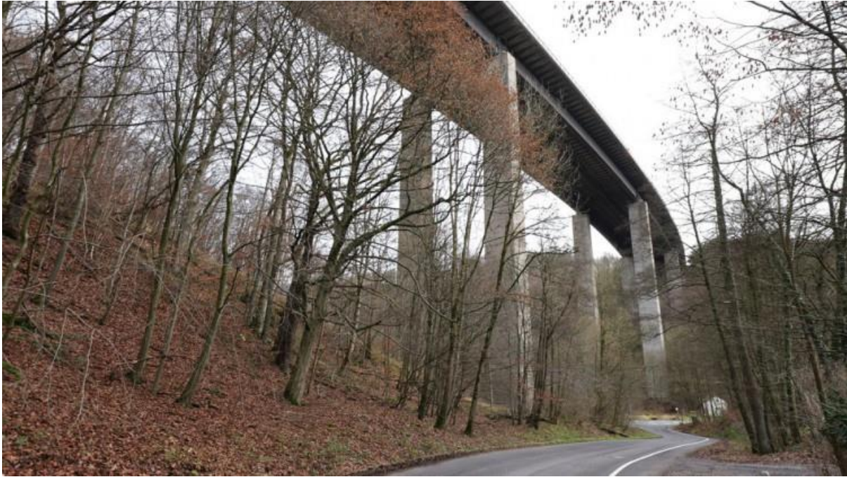
Die Talbrücke Rahmede der A45 ist so marode, dass überhaupt keine Fahrzeuge sie mehr befahren können © Foto: picture alliance / Ralf Ibing/Snowfield Photography | Ralf Ibing
